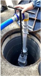
スタンドパイプ
